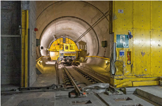
3: Hinter dem durchschlagenen Spurwechsellor das fahrbare Spurwechsellor, das normalerweise zur Aufrechterhaltung einer geregelten Luftzirkulation bei Unterhaltsarbeiten dient Quelle: SBB
