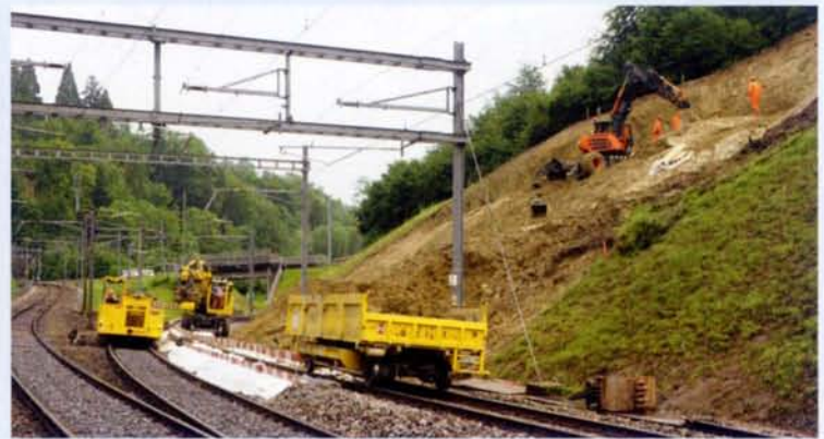
Aufwändiges Abtragen der rutschenden Erdschichten an der bloss auf der Schiene zugänglichen Stelle. 7.6.2024.
