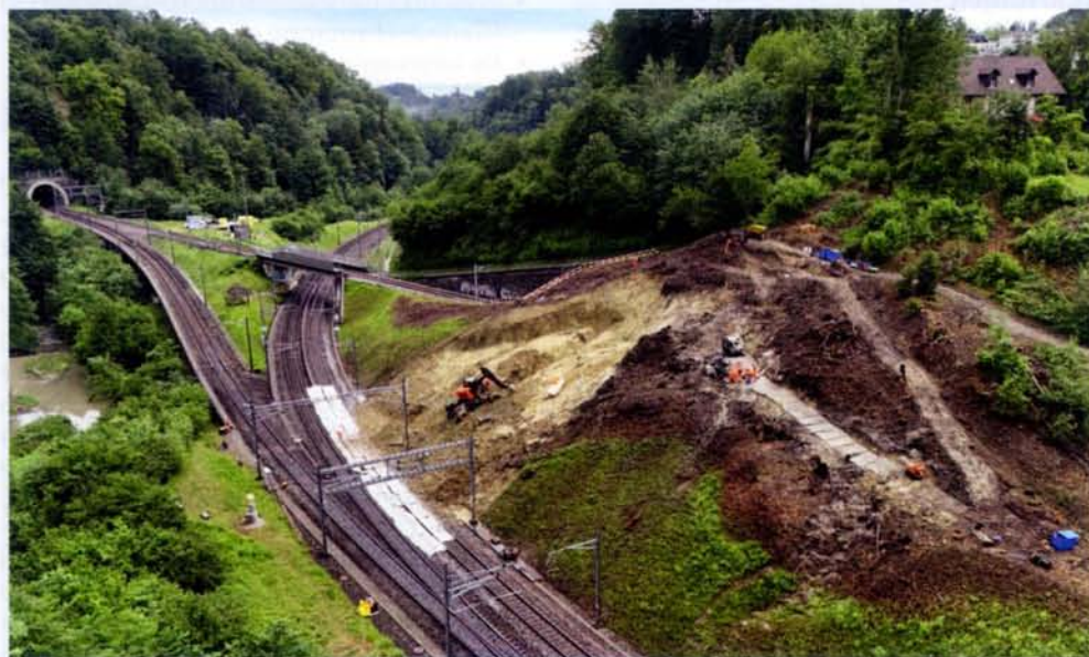
Drohnenaufnahme der Schadstelle am 7.6.2024: in der Mitte die Doppelspur St. Fiden–Mörschwil–Horchentel, diagonal die von der BT 1910 in Betrieb genommene Einspur St. Fiden–Wittenbach vom Galgentobel-tunnel (rechts) zum Bruggwaldtunnel (links), links die 2011 gebaute Spange von den SBB-Gleisen zum SOB-Gleis.
